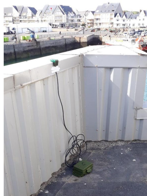
Détecteur posé sur le toit de la criée
