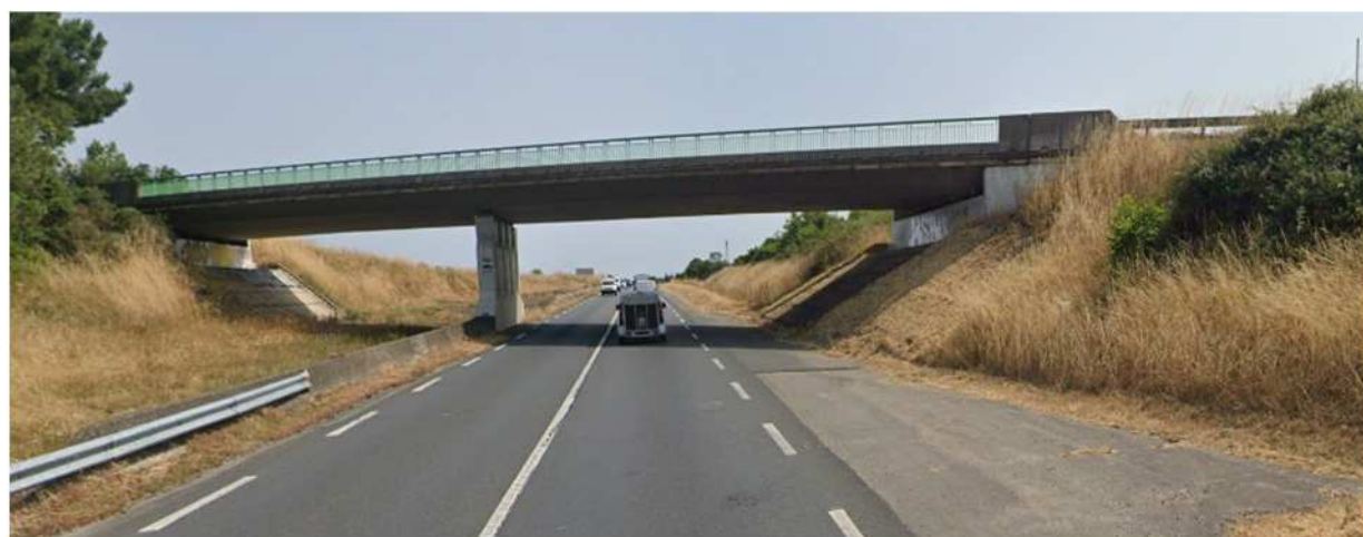
Figure 61 – Franchissement de la RD11 au lieu-dit du « Pérou » - Ouvrage conservé en l'état
